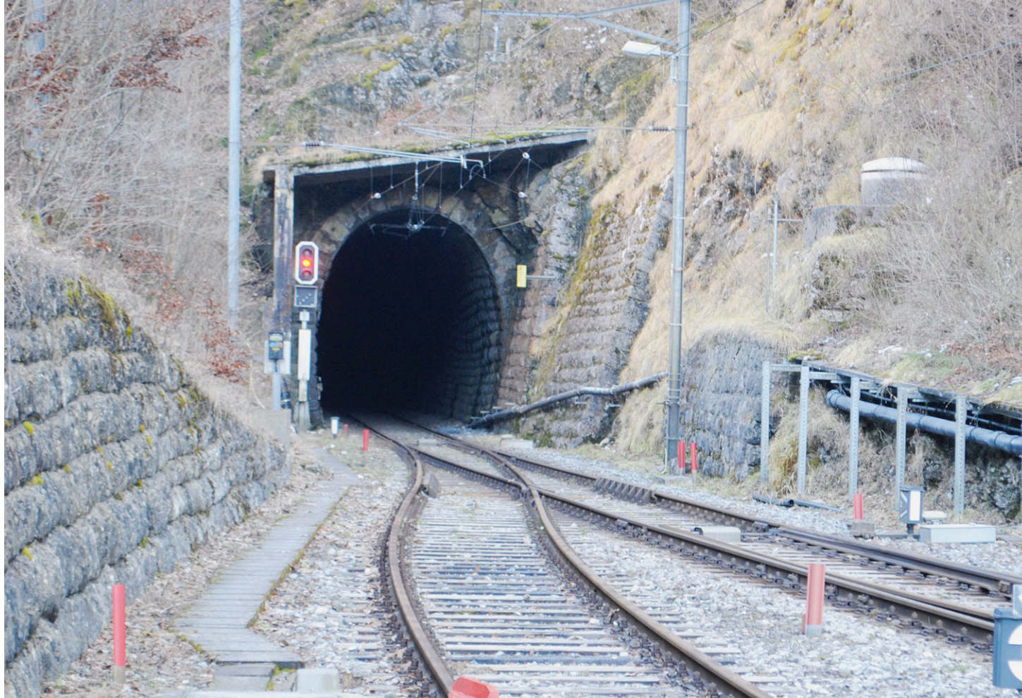
Le tunnel du Weissenstein aura droit à une nécessaire cure de jouvence. Par endroits, des chutes de pierres menacent. MATTHIEU HOFFMANN
